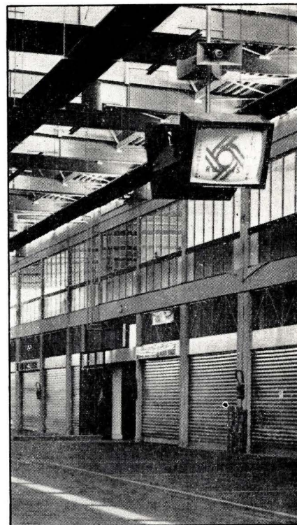
Installation de TV privée dans les nouvelles halles de Rungis, (Compagnie des Compteurs).
